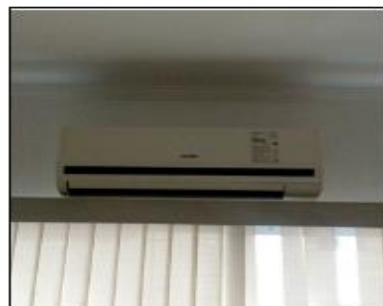
CAM1 - 2 ANDAR - SEDUC AR CONDICIONADO SPLINTER COMFEE 12000
