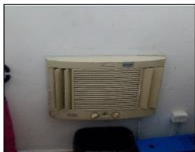
CAM1 - 5 ANDAR - SEHAB AR CONDICIONADO JANELA ELETROLUX 1000 (QUEIMADO) 070778
