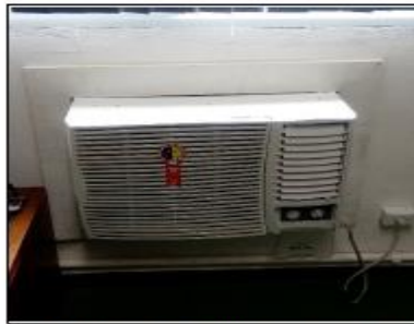
CAM1 - 7 ANDAR - SESPOR AR CONDICIONADO JANELA SPRINGER 18000 121265
