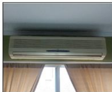
CAM1 - 8 ANDAR - DAPP AR CONDICIONADO SPLINTER FUJITSU 1613
