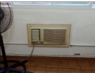
CAM1 - 1 ANDAR - SEAS AR CONDICIONADO JANELA CONSUL 7500
