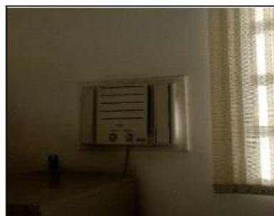
PAÇO - SALA 21 - FAZENDA AR CONDICIONADO JANELA MIDEA 106408
