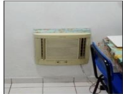
CAM1 - 2 ANDAR - SEDUC AR CONDICIONADO JANELA ELETROLUX 7500 (QUEIMADO)
