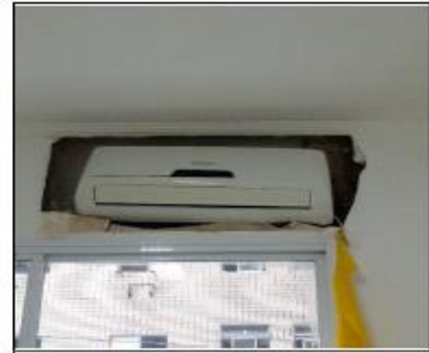
CAM1 - 1 ANDAR - SEAS AR CONDICIONADO SPLINTER ELETROLUX 18000 000126
