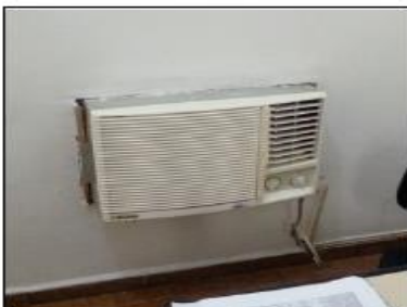
CAM1 - 1 ANDAR - SEAS AR CONDICIONADO JANELA ELGIN 8300
