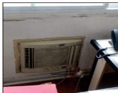
CAM1 - 5 ANDAR - SEHAB AR CONDICIONADO JANELA ELETROLUX 10000 (QUEIMADO) 070777
