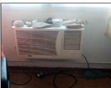
CAM1 - 4 ANDAR - SEMAM AR CONDICIONADO JANELA GREE 37080
