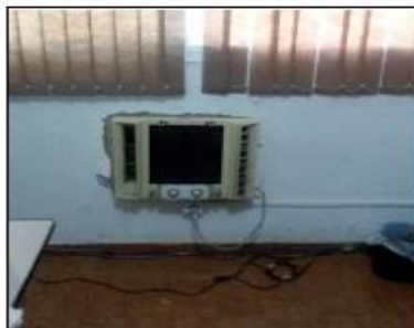
CAM1 - 4 ANDAR - SEMAM AR CONDICIONADO JANELA 065427
