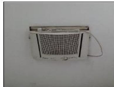
CAM1 - 2 ANDAR - SEDUC AR CONDICIONADO JANELA CONSUL 7500 (QUEIMADO) 093407
