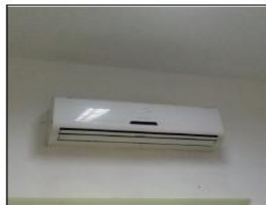
PAÇO - SALA 1 - PROCON AR CONDICIONADO SPLINTER ELETROLUX 090509
