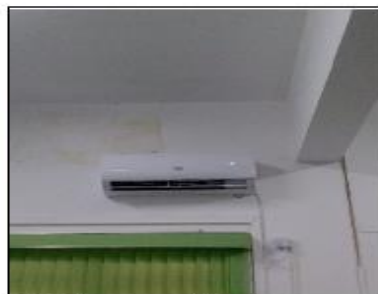
PAÇO - SALA 11 - EXPEDIENTE TRIBUTÁRIO AR CONDICIONADO SPLINTER AGRATTO 108653
