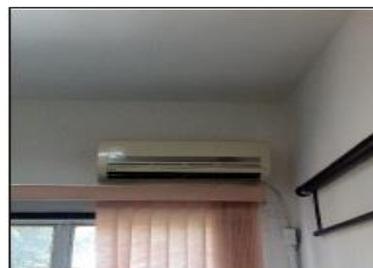
PAÇO - SALA 26 - ADMINISTRAÇÃO AR CONDICIONADO SPLINTER ELGIN 089473
