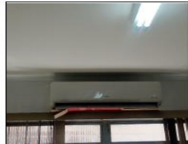
CAM1 - 3 ANDAR - SECINP AR CONDICIONADO SPLINTER MIDEA 093585
