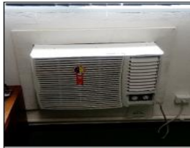
CAM1 - 7 ANDAR - SESPOR AR CONDICIONADO JANELA SPRINGER 18000 121265
