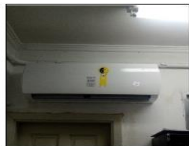
CAM1 - 4 ANDAR - DINF AR CONDICIONADO SPLINTER ELGIN 106427
