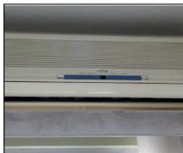
CAM1 - 8 ANDAR - DAPP AR CONDICIONADO SPLINTER FUJITSU
