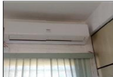
PAÇO - SALA 34 - DIGIP RECURSOS HUMANOS AR CONDICIONADO SPLINTER ELGIN 121121
