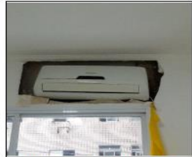
CAM1 - 1 ANDAR - SEAS AR CONDICIONADO SPLINTER ELETROLUX 18000 000126
