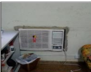
CAM1 - 4 ANDAR - SEMAM AR CONDICIONADO JANELA MIDEA 125964
