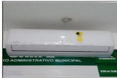
CAM2 - 1 ANDAR - RECEPÇÃO AR CONDICIONADO SPLINTER ELGIN 119400
