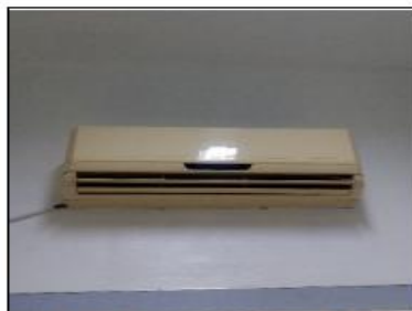
PAÇO - SALA 3 - SEAD AR CONDICIONADO SPLINTER 0722921
