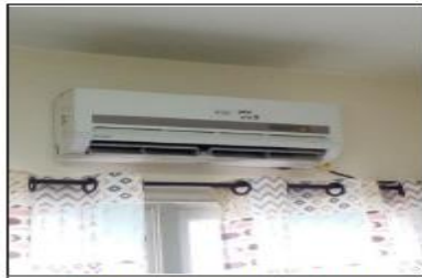
CAM1 - TERREO - JARI SETRANS AR CONDICIONADO SPRINTER ELGIN
