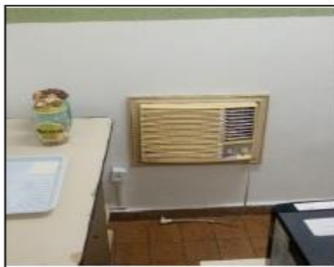
CAM1 - 1 ANDAR - SEAS AR CONDICIONADO JANELA ELGIN 8300
