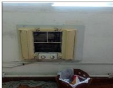
CAM1 - 4 ANDAR - SEMAM AR CONDICIONADO JANELA
