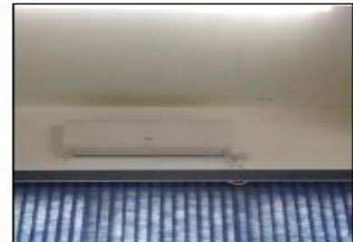
PAÇO - SALA 16 - SECRETARIA DE IMPRENSA E COMUNICAÇÃO AR CONDICIONADOS SPLINTER AGRATTO 118716
