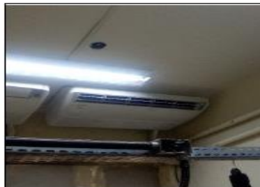
PAÇO - SALA 12 - INFORMATICA AR CONDICIONADO SPLINTER KOMECO 121101
