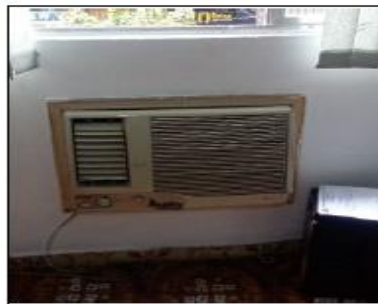
CAM1 - 1 ANDAR - SEAS AR CONDICIONADO JANELA CONSUL 10000
