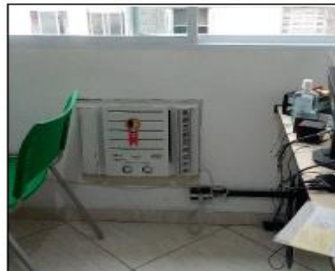
CAM1 - 2 ANDAR - SEDUC AR CONDICIONADO JANELA MIDEA 125174
