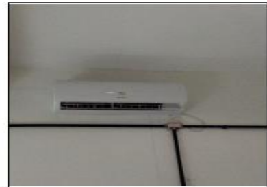
PAÇO - REFEITÓRIO AR CONDICIONADO SPLINTER AGRATTO 118710
