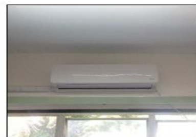
PAÇO - SALA 26 - ADMINISTRAÇÃO AR CONDICIONADO SPLINTER ECOBLUE 121117
