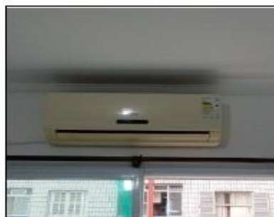
CAM1 - 2 ANDAR - SEDUC AR CONDICIONADO SPLINTER YORK
