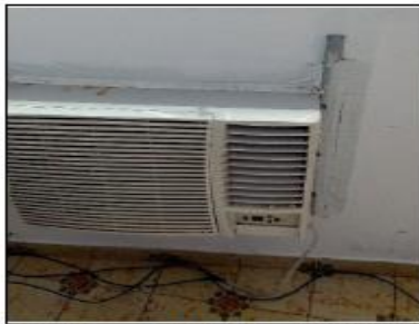
CAM1 - 8 ANDAR - SEDECT AR CONDICIONADO JANELA SPRINGER
