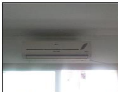
CAM1 - 3 ANDAR - SECINP AR CONDICIONADO SPLINTER KOMECO 093577
