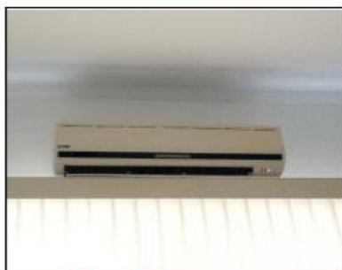
CAM1 - 2 ANDAR - SEDUC AR CONDICIONADO SPLINTER YORK
