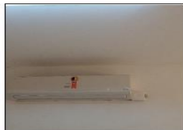
PAÇO - SALA 26 - ADMINISTRAÇÃO AR CONDICIONADO SPLINTER ELGIN 106319
