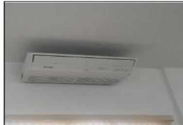
PAÇO - SALA 19 - CONTABILIDADE AR CONDICIONADO SPLINTER ELGIN 105978
