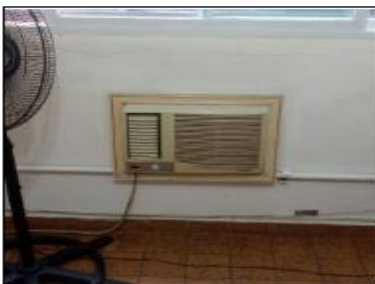
CAM1 - 1 ANDAR - SEAS AR CONDICIONADO JANELA CONSUL 7500
