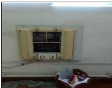
CAM1 - 4 ANDAR - SEMAM AR CONDICIONADO JANELA
