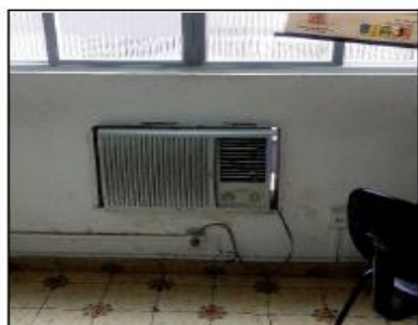
CAM1 - 5 ANDAR - SEHAB AR CONDICIONADO JANELA ELETROLUX 18000 080477
