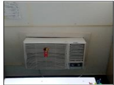
CAM1 - 7 ANDAR - SESPOR AR CONDICIONADO JANELA SPRINGER 18000 121262
