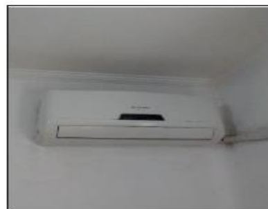
CAM1 - 1 ANDAR - SEAS AR CONDICIONADO SPLINTER ELETROLUX 7500 000125
