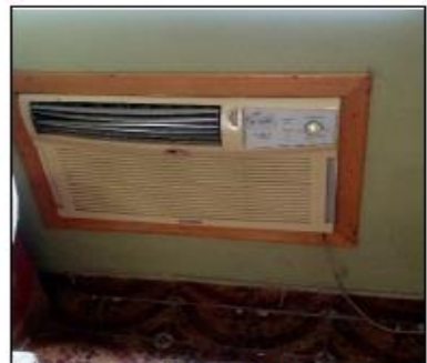
CAM1 - TERREO - ADMINISTRAÇÃO AR CONDICIONADO JANELA CONSUL 12000 073372
