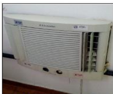
CAM1 - 8 ANDAR - SEDECT AR CONDICIONADO JANELA ELETROLUX 7500 080974
