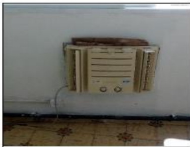
CAM1 - 8 ANDAR - SEDECT AR CONDICIONADO JANELA SPRINGER 065362
