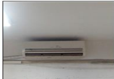
PAÇO - SALA 34 - DIGIP RECURSOS HUMANOS AR CONDICIONADO SPLINTER ELGIN 93532
