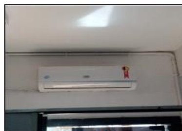
PAÇO - SALA 26 - ADMINISTRAÇÃO AR CONDICIONADO SPLINTER ADMIRAL 108721
