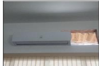
PAÇO - SALA 19 - CONTABILIDADE AR CONDICIONADO SPLINTER ELGIN 118713
