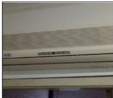
CAM1 - 8 ANDAR - SEDECT AR CONDICIONADO SPLINTER LG 060552
