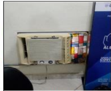
CAM1 - 2 ANDAR - SEDUC AR CONDICIONADO JANELA (QUEBRADO)
