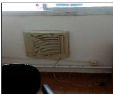
CAM1 - 5 ANDAR - SEHAB AR CONDICIONADO SPLINTER ELETROLUX 10000 070776
