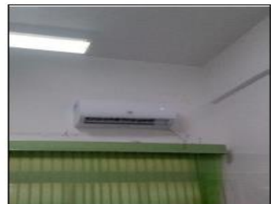
PAÇO - SALA 11 - EXPEDIENTE TRIBUTÁRIO AR CONDICIONADO SPLINTER AGRATTO 108654
