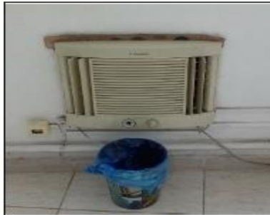
CAM1 - 2 ANDAR - SEDUC AR CONDICIONADO JANELA ELETROLUX 7500
