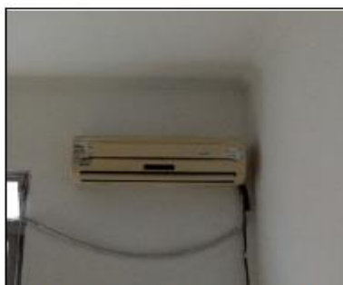
CAM1 - 5 ANDAR - SEHAB AR CONDICIONADO SPLINTER BRIZE 12000 064559
