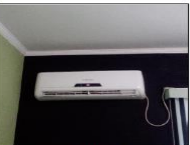
CAM1 - 1 ANDAR - SEAS AR CONDICIONADO SPLINTER ELETROLUX 000128
