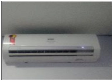
PAÇO - GABINETE PREFEITO AR CONDICIONADO SPLINTER MIDEA 106454
