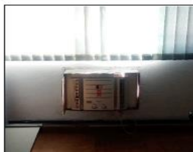
CAM1 - 3 ANDAR - SECINP AR CONDICIONADO JANELA MIDEA 125971
