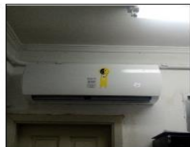
CAM1 - 4 ANDAR - DINF AR CONDICIONADO SPLINTER ELGIN 106427
