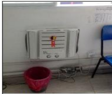
CAM1 - 2 ANDAR - SEDUC AR CONDICIONADO JANELA 7500 125175
