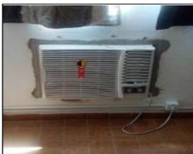
CAM1 - 4 ANDAR - SEMAM AR CONDICIONADO JANELA MIDEA 125965
