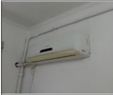
CAM1 - 1 ANDAR - SEAS AR CONDICIONADO SPLINTER ELETROLUX 12000 000127
