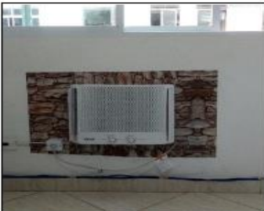
CAM1 - 2 ANDAR - SEDUC AR CONDICIONADO JANELA CONSUL
