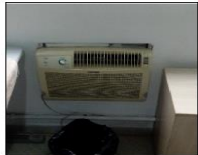
CAM1 - 2 ANDAR - SEDUC AR CONDICIONADO JANELA CONSUL 7500
