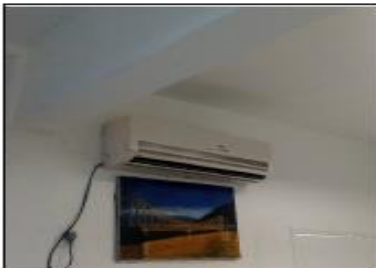
PAÇO - SALA 16 - SECRETARIA DE IMPRENSA E COMUNICAÇÃO AR CONDICIONADO SPLINTER ELGIN 93525
