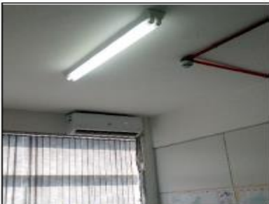
CAM2 - 4 ANDAR - PROJETOS ESPECIAIS AR CONDICIONADO SPLINTER ECOBLUE 121115
