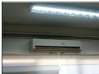
PAÇO - SALA 20 - DIRETÓRIA FINANCEIRA AR CONDICIONADO SPLINTER 93530
