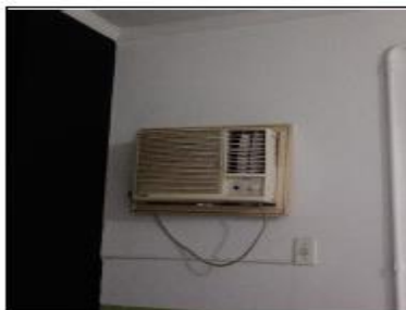
CAM1 - 1 ANDAR - SEAS AR CONDICIONADO JANELA ELGIN 8300
