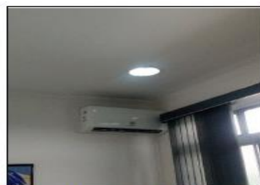
PAÇO - SALA 25 - LICITAÇÕES AR CONDICIONADO SPLINTER PHILCO 128740
