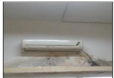
PAÇO - SALA 12 - INFORMATICA AR CONDICIONADO SPLINTER KOMECO 080967
