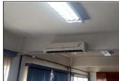
PAÇO - SALA 34 - DIGIP RECURSOS HUMANOS AR CONDICIONADO SPLINTER KOMECO 93572
