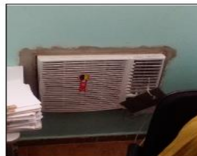
CAM1 - 4 ANDAR - SEMAM AR CONDICIONADO JANELA SPRINGER 125967
