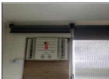
PAÇO - SALA 18 - DIR PLANEJAMENTO ORÇAMENTARIO DIPRECON AR CONDICIONADO JANELA SPRINGER
