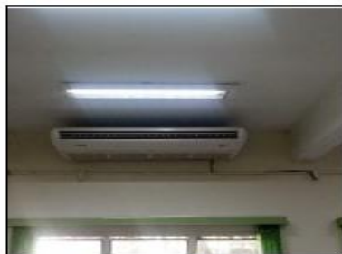
PAÇO - SALA 4 - ATENDIMENTO TRIBUTÁRIO AR CONDICIONADO SPLINTER ELGIN 118778
