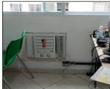
CAM1 - 2 ANDAR - SEDUC AR CONDICIONADO JANELA MIDEA 125174
