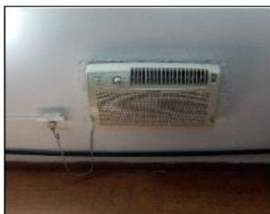
CAM1 - 3 ANDAR - SECINP AR CONDICIONADO JANELA CONSUL
