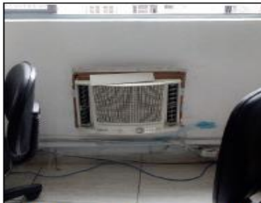
CAM1 - 2 ANDAR - SEDUC AR CONDICIONADO JANELA CONSUL 7500 093405
