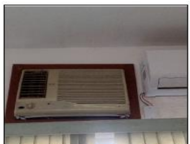
PAÇO - SALA 34 - DIGIP RECURSOS HUMANOS AR CONDICIONADO JANELA CONSUL (QUEIMADO)
