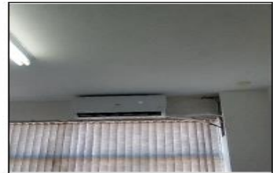
CAM2 - 4 ANDAR - PROJETOS ESPECIAIS AR CONDICIONADO SPLINTER ECOBLUE 121114
