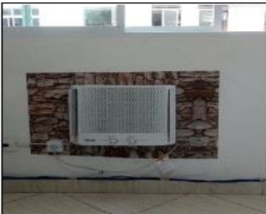
CAM1 - 2 ANDAR - SEDUC AR CONDICIONADO JANELA CONSUL
