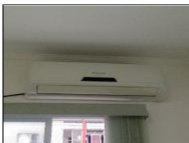
CAM1 - 1 ANDAR - SEAS AR CONDICIONADO SPLINTER ELETROLUX 12000 000129
