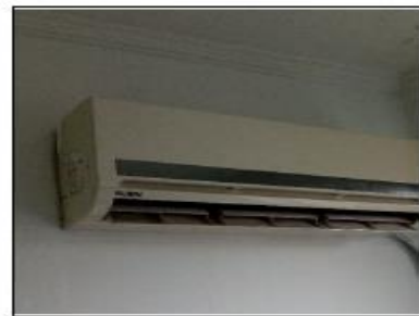
CAM1 - 8 ANDAR - SEDECT AR CONDICIONADO SPLINTER ELGIN
