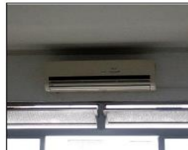
CAM1 - 5 ANDAR - DEAPE AR CONDICIONADO SPLINTER ELGIN 12000 93549
