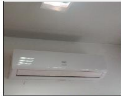
PAÇO - SALA 34 - DIGIP RECURSOS HUMANOS AR CONDICIONADO SPLINTER ELGIN 12111
