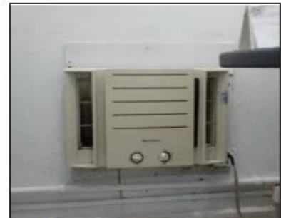
CAM1 - 2 ANDAR - SEDUC AR CONDICIONADO JANELA SPRINGER 7500 (QUEIMADO) 004575
