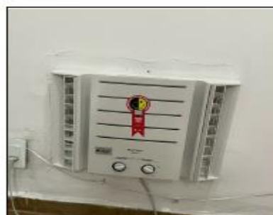
CAM1 - 3 ANDAR - SECINP AR CONDICIONADO JANELA MIDEA 125972
