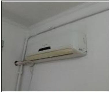
CAM1 - 1 ANDAR - SEAS AR CONDICIONADO SPLINTER ELETROLUX 12000 000127
