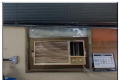
PAÇO - SALA 25 - LICITAÇÕES AR CONDICIONADO JANELA
