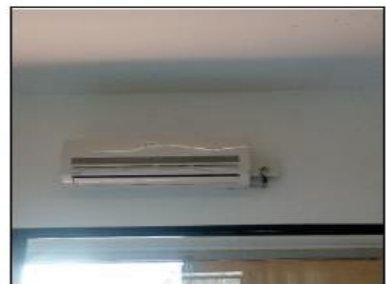
PAÇO - SALA 32 - DIRETORIA GESTÃO AR CONDICIONADO SPLINTER ELGIN 104484
