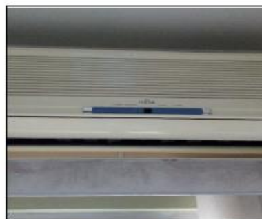
CAM1 - 8 ANDAR - DAPP AR CONDICIONADO SPLINTER FUJITSU
