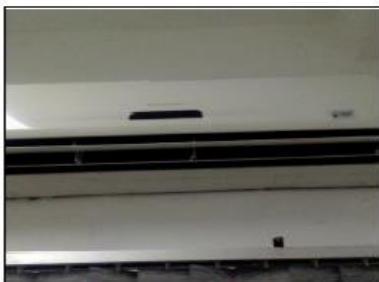
PAÇO - SALA 2 - PROTOCOLO AR CONDICIONADO SPLINTER ELETROLUX 071301
