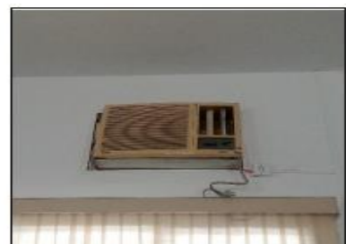
PAÇO - SALA 19 - CONTABILIDADE AR CONDICIONADO JANELA ELGIN (QUEIMADO)
