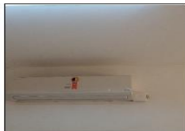
PAÇO - SALA 26 - ADMINISTRAÇÃO AR CONDICIONADO SPLINTER ELGIN 106319
