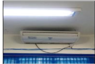
PAÇO - SALA 22 - FISCALIZAÇÃO TRIBUTÁRIA AR CONDICIONADO SPLINTER SPRINGER 121125
