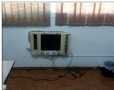
CAM1 - 4 ANDAR - SEMAM AR CONDICIONADO JANELA 065427
