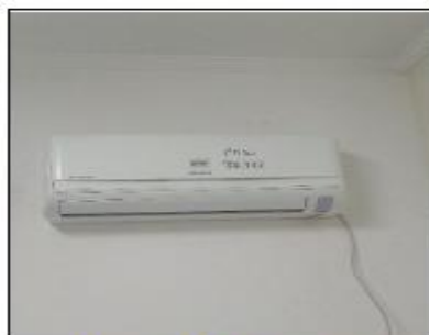
CAM1 - 2 ANDAR - SEDUC AR CONDICIONADO SPLINTER SAMSUNG 106333
