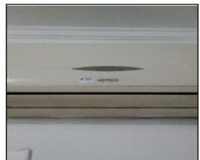
CAM1 - 8 ANDAR - DAPP AR CONDICIONADO SPLINTER KOMECO 091470
