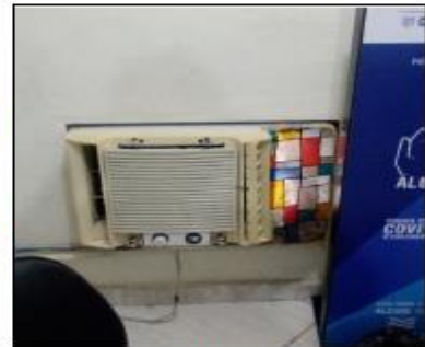
CAM1 - 2 ANDAR - SEDUC AR CONDICIONADO JANELA (QUEBRADO)
