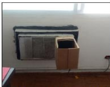
CAM1 - 4 ANDAR - SEMAM AR CONDICIONADO JANELA GENERICO 065318
