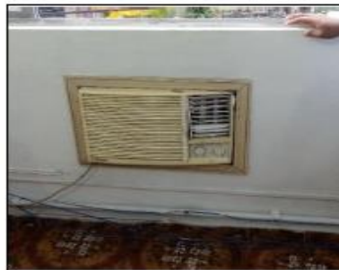
CAM1 - 1 ANDAR - SEAS AR CONDICIONADO JANELA CONSUL 83000
