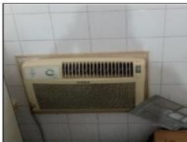
CAM1 - 1 ANDAR - SEAS AR CONDICIONADO JANELA CONSUL 7500
