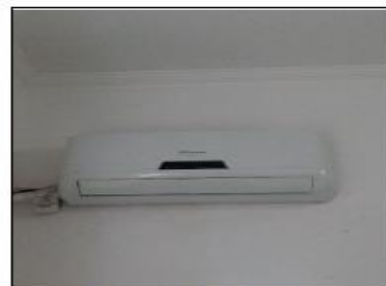
CAM1 - 1 ANDAR - SEAS AR CONDICIONADO SPLINTER ELETROLUX 12000 000103
