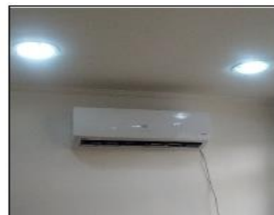
PAÇO - SALA 21 - FAZENDA AR CONDICIONADO SPLINTER ECO BLUE 121116
