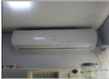
PAÇO - GABINETE PREFEITO AR CONDICIONADO SPLINTER ELGIN 118775
