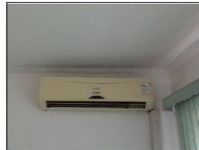
CAM1 - 5 ANDAR - SEHAB AR CONDICIONADO SPLINTER YORK 12000 (QUEIMADO) 070221
