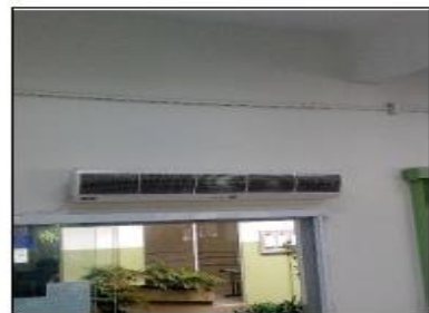
PAÇO - SALA 4 - ATENDIMENTO TRIBUTÁRIO CORTINA DE VENTO SPRINGER 125921
