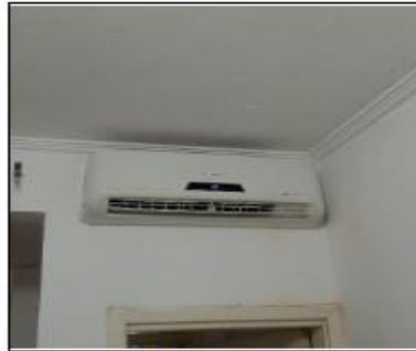
CAM1 - 1 ANDAR - SEAS AR CONDICIONADO SPLINTER ELETROLUX 12000 000120
