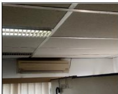
PAÇO - SALA 12 - INFORMATICA AR CONDICIONADO SPLINTER SPRINGER 066126
