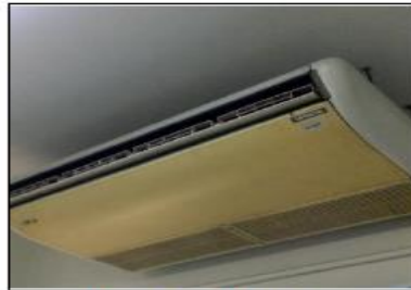
PAÇO - SALA 22 - FISCALIZAÇÃO TRIBUTÁRIA AR CONDICIONADO SPLINTER HITACHI (QUEIMADO) 073010
