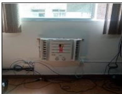
CAM1 - 3 ANDAR - SECINP AR CONDICIONADO JANELA MIDEIA 125969
