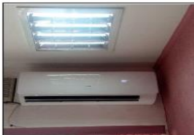
PAÇO - SALA 25 - LICITAÇÕES AR CONDICIONADO SPLINTER ECO BLUE 121119
