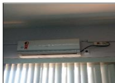
PAÇO - SALA 28 - SECRETÁRIA DE GOVERNO AR CONDICIONADO SPLINTER ADMIRAL 117409
