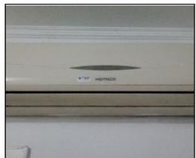
CAM1 - 8 ANDAR - DAPP AR CONDICIONADO SPLINTER KOMECO 091470
