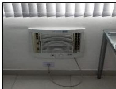
CAM1 - 6 ANDAR - SEPLAN AR CONDICIONADO JANELA ELETROLUX 7500 093496
