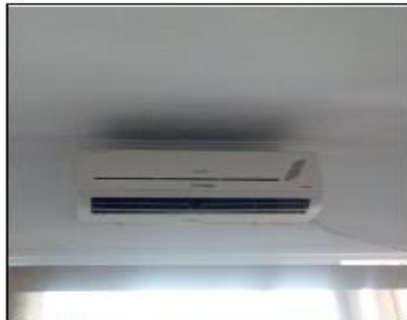
CAM1 - 3 ANDAR - SECINP AR CONDICIONADO SPLINTER KOMECO 093581
