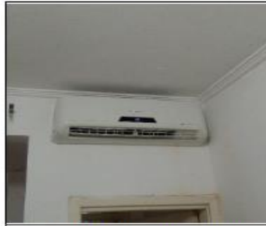
CAM1 - 1 ANDAR - SEAS AR CONDICIONADO SPLINTER ELETROLUX 12000 000120
