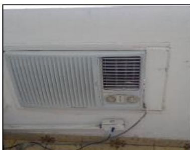
CAM1 - 5 ANDAR - SEHAB AR CONDICIONADO JANELA ELETROLUX 18000 (QUEIMADO) 070775
