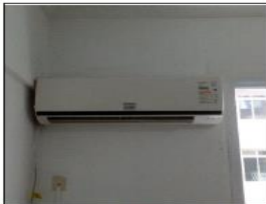
CAM1 - 5 ANDAR - SEHAB AR CONDICIONADO SPLINTER GREE 12000 (QUEIMADO) 073191
