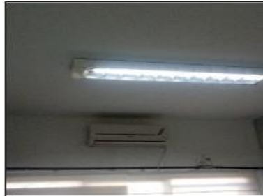
PAÇO - SALA 20 - DIRETÓRIA FINANCEIRA AR CONDICIONADO SPLINTER KOMECO 093573
