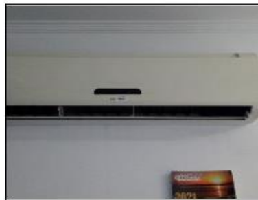
CAM1 - 8 ANDAR - SEDECT AR CONDICIONADO SPLINTER ELETROLUX 061178
