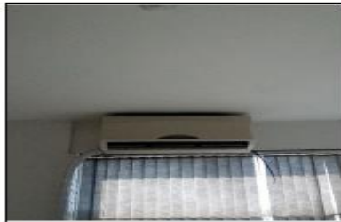
CAM2 - 2 ANDAR - CARTÓRIO ELEITORAL AR CONDICIONADO SPLINTER KOMECO 090275
