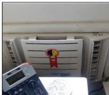
CAM1 - TERREO - ADMINISTRAÇÃO AR CONDICIONADO JANELA MIDEA 119217
