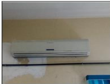
PAÇO - SALA 25 - LICITAÇÕES AR CONDICIONADO SPLINTER ELETROLUX 070766
