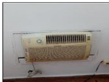
CAM1 - 7 ANDAR - OUVIDORIA GUARDA MUNICIPAL AR CONDICIONADO JANELA CONSUL 7500 (QUEIMADO) 056734
