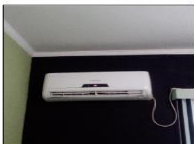
CAM1 - 1 ANDAR - SEAS AR CONDICIONADO SPLINTER ELETROLUX 000128
