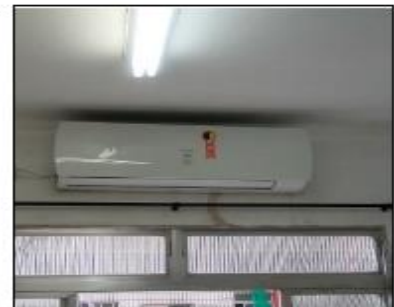
CAM1 - 2 ANDAR - SEDUC AR CONDICIONADO SPLINTER ELGIN 106423
