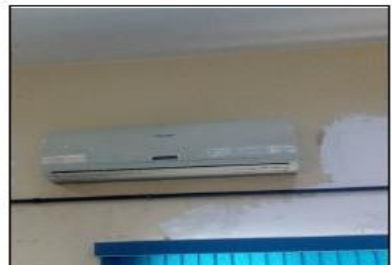
PAÇO - SALA 25 - LICITAÇÕES AR CONDICIONADO SPLINTER ELETROLUX 070767
