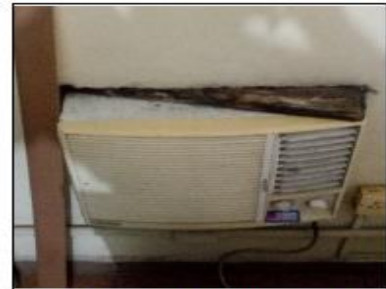
CAM1 - 1 ANDAR - SEAS AR CONDICIONADO JANELA ELGIN 7500
