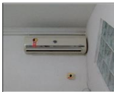
CAM1 - 2 ANDAR - SEDUC AR CONDICIONADO SPLINTER PHILCO (QUEIMADO)
