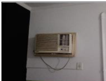
CAM1 - 1 ANDAR - SEAS AR CONDICIONADO JANELA ELGIN 8300
