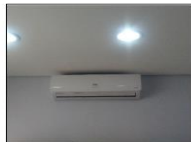
PAÇO - GABINETE PREFEITO AR CONDICIONADO SPLINTER ECOBLUE 121118
