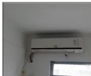
CAM1 - 5 ANDAR - SEHAB AR CONDICIONADO SPLINTER GREE 12000 073190
