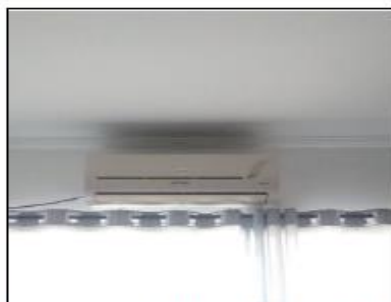
CAM1 - 3 ANDAR - SECINP AR CONDICIONADO SPLINTER KOMECO 093679
