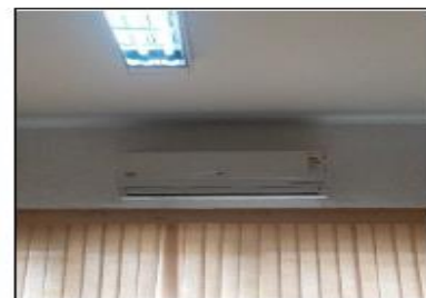
PAÇO - SALA 26 - ADMINISTRAÇÃO AR CONDICIONADO SPLINTER LG 011911
