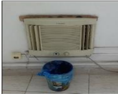
CAM1 - 2 ANDAR - SEDUC AR CONDICIONADO JANELA ELETROLUX 7500
