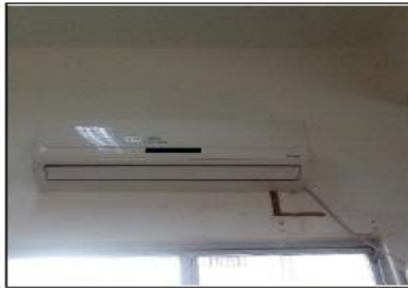
PAÇO - SALA 15 - CONTROLADORIA AR CONDICIONADO SPLINTER BRIZE 93453
