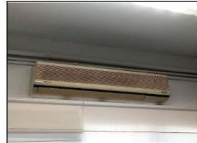
PAÇO - SALA 20 - DIRETÓRIA FINANCEIRA AR CONDICIONADO SPLINTER PANASONIC 030092
