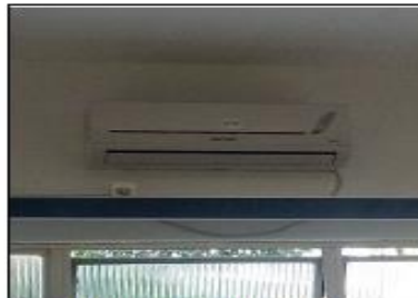
PAÇO - SALA 16 - SECRETARIA DE IMPRENSA E COMUNICAÇÃO AR CONDICIONADO SPLINTER KOMECO 093566
