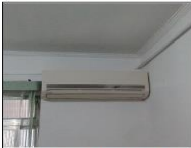
CAM1 - 1 ANDAR - SEAS AR CONDICIONADO SPLINTER ELGIN 000131
