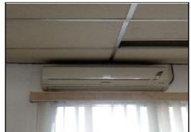
PAÇO - SALA 12 - INFORMATICA AR CONDICIONADO SPLINTER KOMECO 080968
