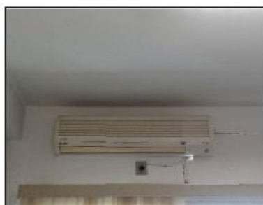
PAÇO - SALA 32 - DIRETORIA GESTÃO AR CONDICIONADO SPLINTER ELGIN (QUEBRADO) 065671
