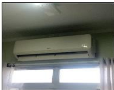
CAM1 - 3 ANDAR - SECINP AR CONDICIONADO SPLINTER MIDEA 93584
