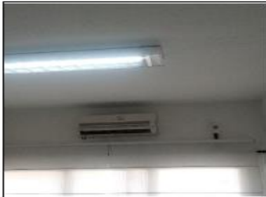
PAÇO - SALA 20 - DIRETÓRIA FINANCEIRA AR CONDICIONADO SPLINTER ELGIN 93540
