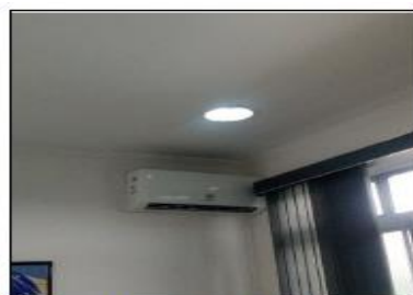
PAÇO - SALA 25 - LICITAÇÕES AR CONDICIONADO SPLINTER PHILCO 128740
