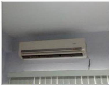
PAÇO - SALA 28 - SECRETARIA DE GOVERNO AR CONDICIONADO SPLINTER ELGIN 073157
