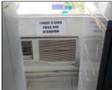
CAM1 - 2 ANDAR - SEDUC AR CONDICIONADO JANELA CONSUL 18000
