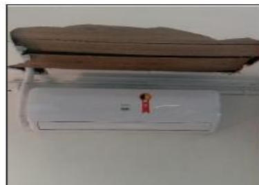
PAÇO - SALA 18 - DIR PLANEJAMENTO ORÇAMENTARIO DIPRECON AR CONDICIONADO SPLINTER ELGIN 119515
