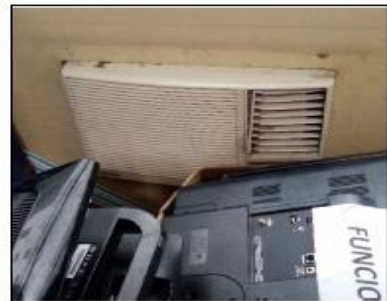
CAM1 - 1 ANDAR - SEAS AR CONDICIONADO JANELA ELGIN
