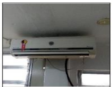
CAM1 - 2 ANDAR - SEDUC AR CONDICIONADO SPLINTER PHILCO 12000
