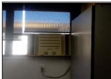
PAÇO - SALA 18 - DIR PLANEJAMENTO ORÇAMENTARIO DIPRECON AR CONDICIONADO JANELA SPRINGER 065196
