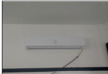
PAÇO - SALA 19 - CONTABILIDADE AR CONDICIONADO SPLINTER ELGIN 118714
