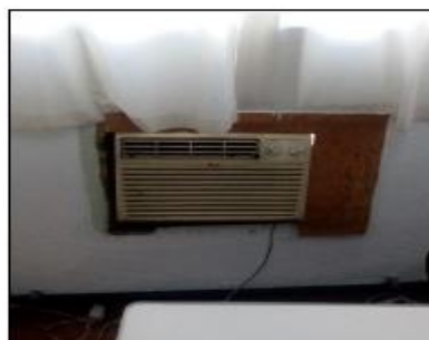
CAM1 - 3 ANDAR - SECINP AR CONDICIONADO JANELA LG
