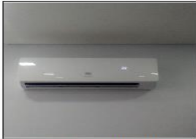
PAÇO - GABINETE PREFEITO AR CONDICIONADO SPLINTER ECOCLUE 121120
