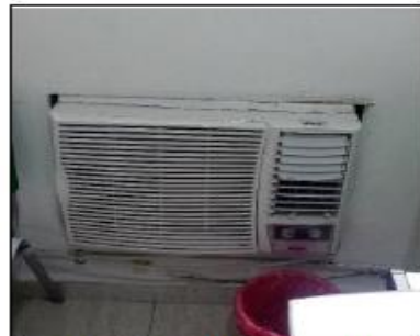
CAM1 - 2 ANDAR - SEDUC AR CONDICIONADO JANELA MIDEA 125176
