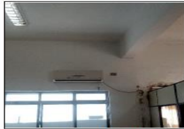
PAÇO - SALA 15 - CONTROLADORIA AR CONDICIONADO SPLINTER KOMECO 93454
