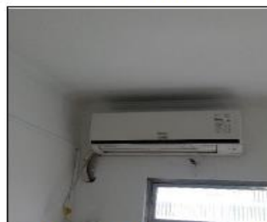
CAM1 - 5 ANDAR - SEHAB AR CONDICIONADO SPLINTER GREE 12000 073190
