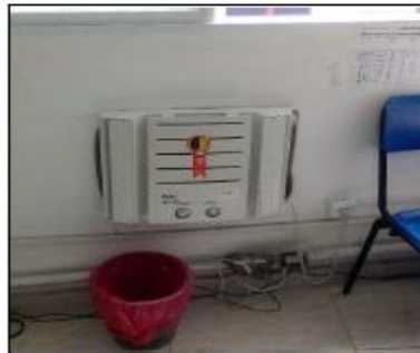
CAM1 - 2 ANDAR - SEDUC AR CONDICIONADO JANELA 7500 125175
