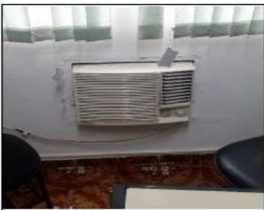
CAM1 - 1 ANDAR - SEAS AR CONDICIONADO JANELA ELGIN 8300
