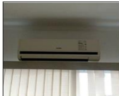
CAM1 - 2 ANDAR - SEDUC AR CONDICIONADO SPLINTER COMFEE 12000
