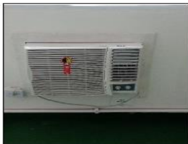
CAM1 - 7 ANDAR - SESPOR AR CONDICIONADO JANELA SPRINGER 18000 121264
