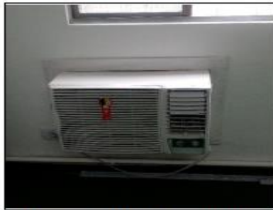
CAM1 - 7 ANDAR - SESPOR AR CONDICIONADO JANELA SPRINGER 18000 121263
