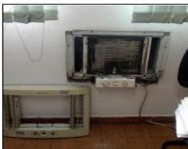
CAM1 - 5 ANDAR - SEHAB AR CONDICIONADO JANELA ELETROLUX 10000 070779
