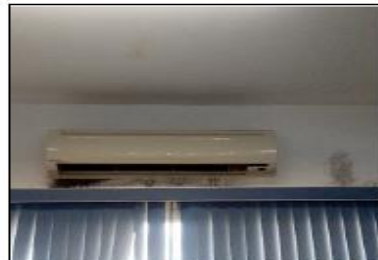
PAÇO - SALA 34 - DIGIP RECURSOS HUMANOS AR CONDICIONADO SPLINTER SPRINGER 73013
