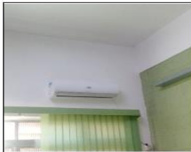
PAÇO - SALA 11 - EXPEDIENTE TRIBUTÁRIO AR CONDICIONADO SPLINTER AGRATTO 108652
