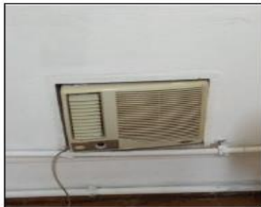
CAM1 - 1 ANDAR - SEAS AR CONDICIONADO JANELA CONSUL 7500 36143
