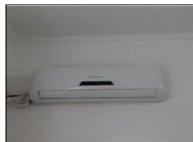
CAM1 - 1 ANDAR - SEAS AR CONDICIONADO SPLINTER ELETROLUX 12000 000103
