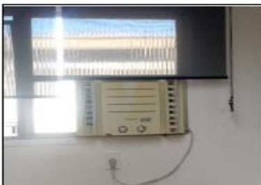
PAÇO - SALA 18 - DIR PLANEJAMENTO ORÇAMENTARIO DIPRECON AR CONDICIONADO JANELA SPRINGER 065197
