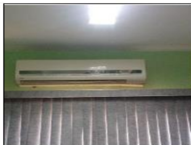
PAÇO - SALA 30 - COGP AR CONDICIONADO SPLINTER ELGIN 104923
