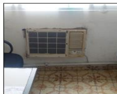
CAM1 - 4 ANDAR - SEMAM AR CONDICIONADO JANELA LG
