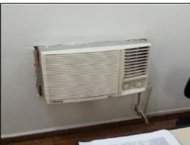
CAM1 - 1 ANDAR - SEAS AR CONDICIONADO JANELA ELGIN 8300
