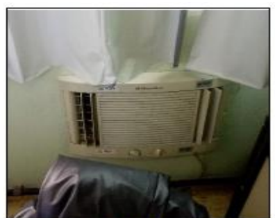
CAM1 - 8 ANDAR - SEDECT AR CONDICIONADO JANELA ELETROLUX 7500 080971
