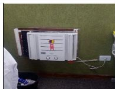
CAM1 - 3 ANDAR - SECINP AR CONDICIONADO JANELA MIDEA 125970
