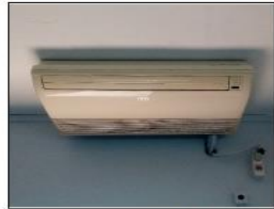
PAÇO - SALA 28 - SECRETARIA DE GOVERNO AR CONDICIONADO SPLINTER FUJITSU 056724
