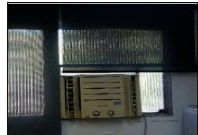
PAÇO - SALA 18 - DIR PLANEJAMENTO ORÇAMENTARIO DIPRECON AR CONDICIONADO JANELA SPRINGER 065195
