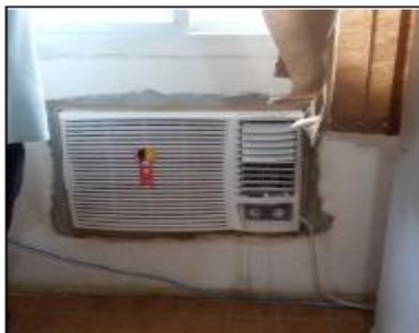
CAM1 - 4 ANDAR - SEMAM AR CONDICIONADO JANELA SPRINGER 125966
