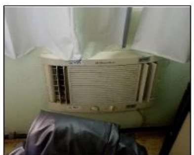
CAM1 - 8 ANDAR - SEDECT AR CONDICIONADO JANELA ELETROLUX 7500 080971
