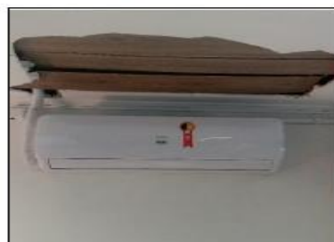
PAÇO - SALA 18 - DIR PLANEJAMENTO ORÇAMENTARIO DIPRECON AR CONDICIONADO SPLINTER ELGIN 119515
