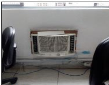
CAM1 - 2 ANDAR - SEDUC AR CONDICIONADO JANELA CONSUL 7500 093405
