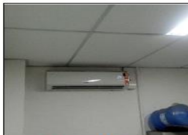
PAÇO - SALA 12 - INFORMATICA AR CONDICIONADO SPLINTER ELGIN 106090
