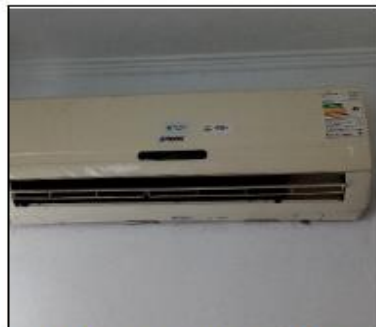
CAM1 - 8 ANDAR - SEDECT AR CONDICIONADO SPLINTER YORK 080416
