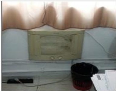
CAM1 - 2 ANDAR - SEDUC AR CONDICIONADO JANELA ELETROLUX 7500
