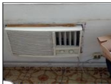
CAM1 - 7 ANDAR - JUNTA MILITAR AR CONDICIONADO JANELA ELGIN 12000
