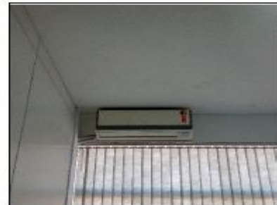
CAM2 - 5 ANDAR - SEJUR AR CONDICIONADO SPLINTER HITACHI
