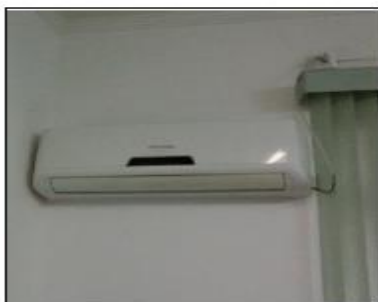
CAM1 - 1 ANDAR - SEAS AR CONDICIONADO SPLINTER ELETROLUX 12000
