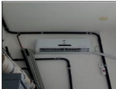
CAM2 - 4 ANDAR - PROJETOS ESPECIAIS AR CONDICIONADO SPLINTER ELETROLUX 125920
