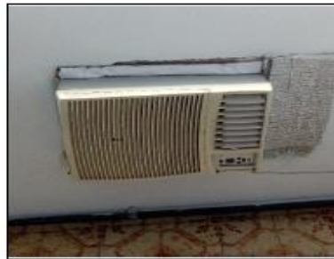
CAM1 - 8 ANDAR - SEDECT AR CONDICIONADO JANELA SPRINGER 073062
