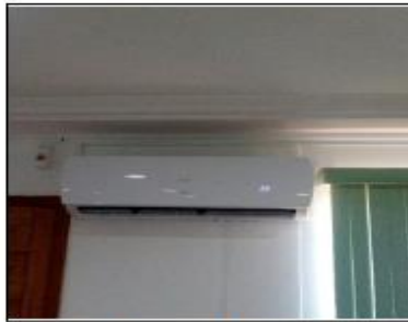
PAÇO - SALA 28 - SECRETARIA DE GOVERNO AR CONDICIONADO SPLINTER ELGIN 118664
