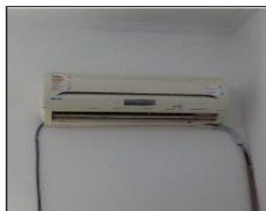
CAM1 - 5 ANDAR - SEHAB AR CONDICIONADO SPLINTER BRIZE 064556
