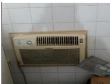
CAM1 - 1 ANDAR - SEAS AR CONDICIONADO JANELA CONSUL 7500
