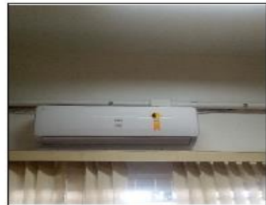
PAÇO - SALA 12 - INFORMATICA AR CONDICIONADO SPLINTER ELGIN 119046
