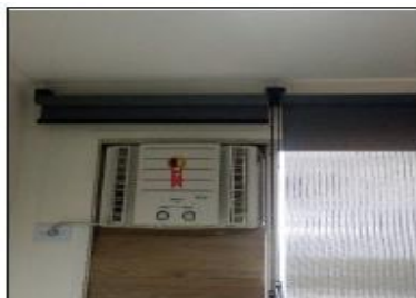
PAÇO - SALA 18 - DIR PLANEJAMENTO ORÇAMENTARIO DIPRECON AR CONDICIONADO JANELA SPRINGER
