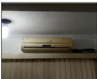
CAM1 - 5 ANDAR - SEHAB AR CONDICIONADO SPLINTER BRIZE 12000 044551
