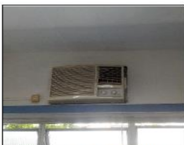
PAÇO - SALA 34 - DIGIP RECURSOS HUMANOS AR CONDICIONADO JANELA
