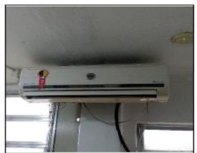
CAM1 - 2 ANDAR - SEDUC AR CONDICIONADO SPLINTER PHILCO 12000
