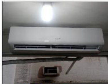
CAM1 - 1 ANDAR - SEAS AR CONDICIONADO SPLINTER ELGIN 000578
