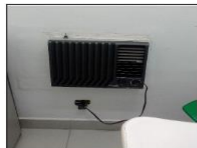
CAM1 - 6 ANDAR - SEPLAN AR CONDICIONADO JANELA SPRINGER 7500
