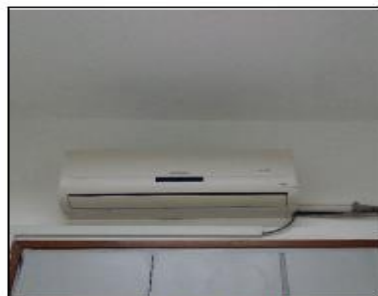
PAÇO - SALA 1 - PROCON AR CONDICIONADO SPLINTER KOMECO 090555
