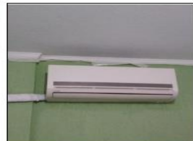
CAM1 - 1 ANDAR - SEAS AR CONDICIONADO SPLINTER 000130
