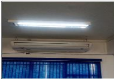
PAÇO - SALA 22 - FISCALIZAÇÃO TRIBUTÁRIA AR CONDICIONADO SPLINTER ELGIN 128743
