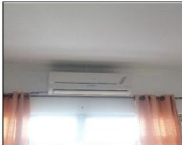
CAM1 - 3 ANDAR - SECINP AR CONDICIONADO SPLINTER KOMECO 093580
