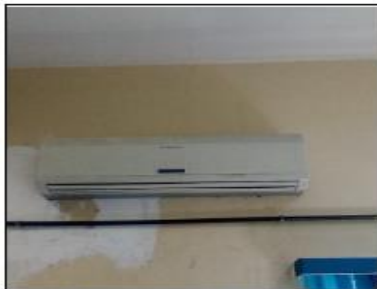
PAÇO - SALA 25 - LICITAÇÕES AR CONDICIONADO SPLINTER ELETROLUX 070766
