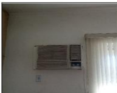
PAÇO - SALA 21 - FAZENDA AR CONDICIONADO JANELA MIDEA 108750
