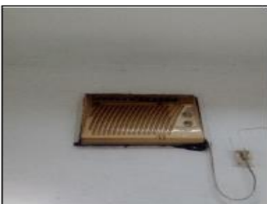
PAÇO - COPA AR CONDICIONADO JANELA
