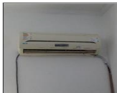
CAM1 - 5 ANDAR - SEHAB AR CONDICIONADO SPLINTER BRIZE 064556
