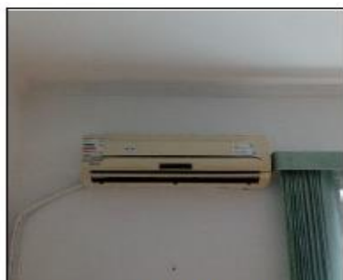
CAM1 - 5 ANDAR - SEHAB AR CONDICIONADO SPLINTER BRIZE 12000 064557
