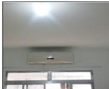
CAM1 - 2 ANDAR - SEDUC AR CONDICIONADO SPLINTER ELETROLUX 082945
