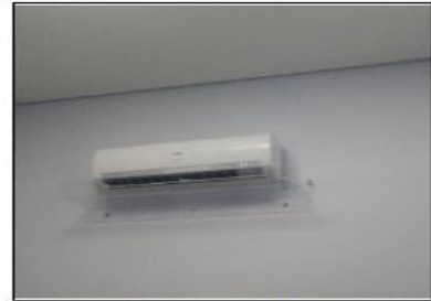
PAÇO - GABINETE PREFEITO AR CONDICIONADO SPLINTER MIDEA 106453
