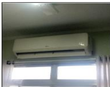
CAM1 - 3 ANDAR - SECINP AR CONDICIONADO SPLINTER MIDEA 93584
