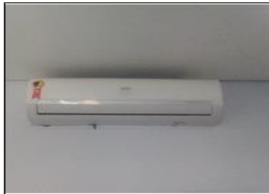
PAÇO - GABINETE PREFEITO AR CONDICIONADO SPLINTER MIDEA (VAZAMENTO) 106452
