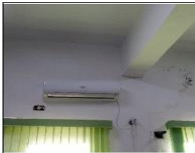
PAÇO - SALA 11 - EXPEDIENTE TRIBUTÁRIO AR CONDICIONADO SPLINTER AGRATTO 108651
