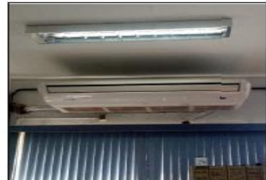
PAÇO - SALA 34 - DIGIP RECURSOS HUMANOS AR CONDICIONADO SPLINTER ELGIN 118779
