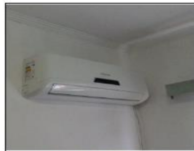
CAM1 - 1 ANDAR - SEAS AR CONDICIONADO SPLINTER ELETROLUX 000123
