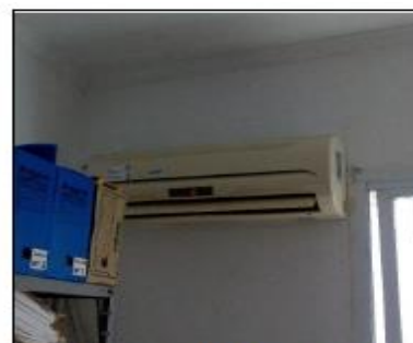
CAM1 - 5 ANDAR - SEHAB AR CONDICIONADO SPLINTER BRIZE 12000 064560
