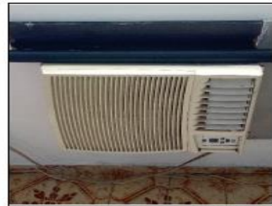
CAM1 - 8 ANDAR - SEDECT AR CONDICIONADO JANELA SPRINGER 073063
