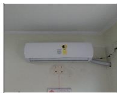
CAM1 - 2 ANDAR - SEDUC AR CONDICIONADO SPLINTER ELGIN 7500 106426
