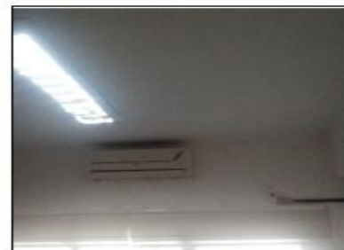
PAÇO - SALA 20 - DIRETÓRIA FINANCEIRA AR CONDICIONADO SPLINTER 093574
