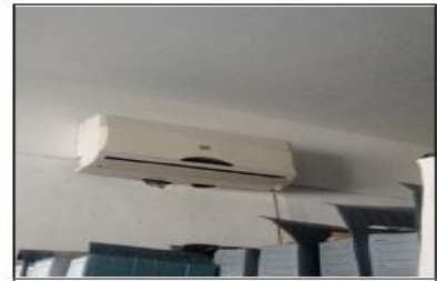
CAM2 - 2 ANDAR - CARTÓRIO ELEITORAL AR CONDICIONADO SPLINTER 090276
