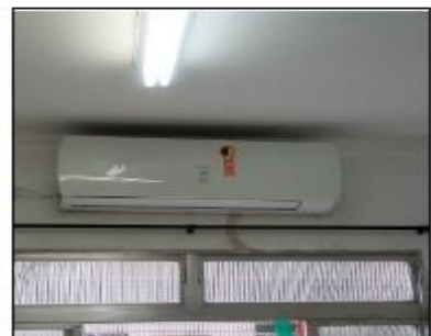
CAM1 - 2 ANDAR - SEDUC AR CONDICIONADO SPLINTER ELGIN 106423
