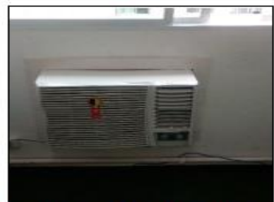
CAM1 - 7 ANDAR - SESPOR AR CONDICIONADO JANELA SPRINGER 1800 121261
