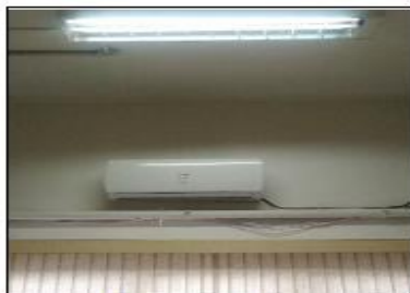
PAÇO - SALA 12 - INFORMATICA AR CONDICIONADO SPLINTER ELGIN 104429
