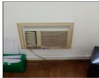
CAM1 - 1 ANDAR - SEAS AR CONDICIONADO JANELA CONSUL 7500
