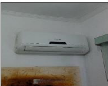
CAM1 - 1 ANDAR - SEAS AR CONDICIONADO SPLINTER ELETROLUX 12000 000124
