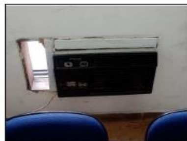
CAM1 - 7 ANDAR - JUNTA MILITAR AR CONDICIONADO JANELA SPRINGER 7000 (QUEIMADO)
