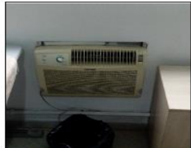
CAM1 - 2 ANDAR - SEDUC AR CONDICIONADO JANELA CONSUL 7500
