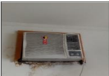
PAÇO - SALA 25 - LICITAÇÕES AR CONDICIONADO JANELA MIDEIA 119223
