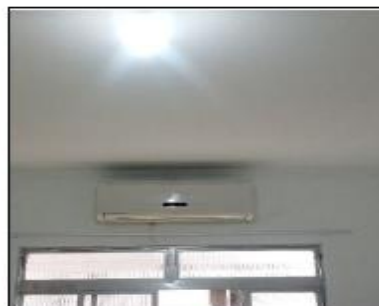
CAM1 - 2 ANDAR - SEDUC AR CONDICIONADO SPLINTER ELETROLUX 082945
