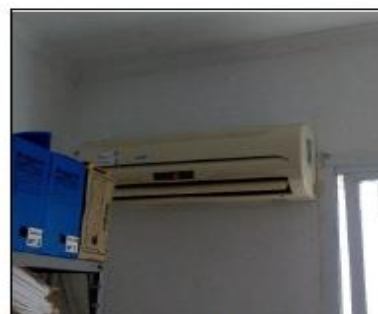
CAM1 - 5 ANDAR - SEHAB AR CONDICIONADO SPLINTER BRIZE 12000 064560
