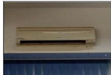
PAÇO - SALA 34 - DIGIP RECURSOS HUMANOS AR CONDICIONADO SPLINTER SPRINGER (QUEIMADO) 073013
