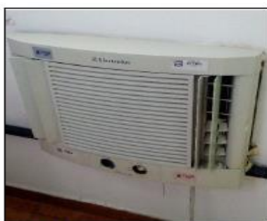
CAM1 - 8 ANDAR - SEDECT AR CONDICIONADO JANELA ELETROLUX 7500 080974
