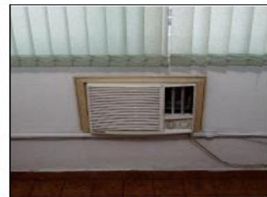
CAM1 - 1 ANDAR - SEAS AR CONDICIONADO JANELA ELGIN 8300
