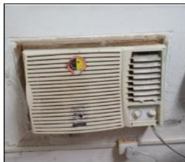
CAM1 - TERREO - ADMINISTRAÇÃO AR CONDICIONADO JANELA SPRINGER
