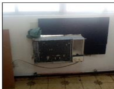
CAM1 - 3 ANDAR - SECINP AR CONDICIONADO JANELA (QUEIMADO)
