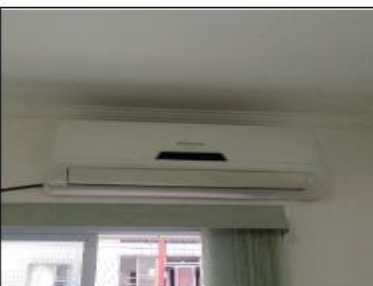
CAM1 - 1 ANDAR - SEAS AR CONDICIONADO SPLINTER ELETROLUX 12000 000129
