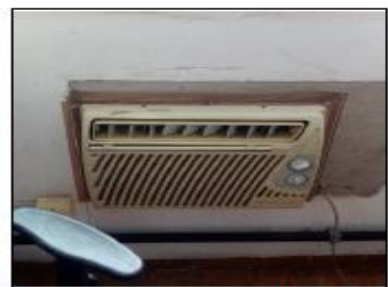
CAM1 - 7 ANDAR - JUNTA MILITAR AR CONDICIONADO JANELA SPRINGER (QUEIMADO) 28645
