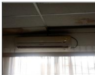
PAÇO - SALA 12 - INFORMATICA AR CONDICIONADO SPLINTER KOMECO 080969
