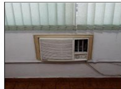
CAM1 - 1 ANDAR - SEAS AR CONDICIONADO JANELA ELGIN 8300
