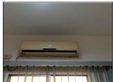
PAÇO - SALA 3 - SEAD AR CONDICIONADO SPLINTER CARRIER 0722928
