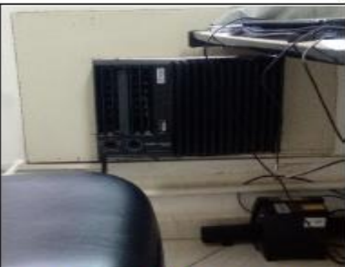
CAM1 - 2 ANDAR - SEDUC AR CONDICIONADO JANELA CONSUL 7500 001644
