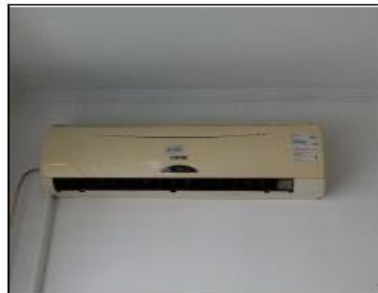
CAM1 - 5 ANDAR - SEHAB AR CONDICIONADO SPLINTER YORK 12000 070819
