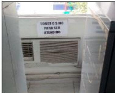
CAM1 - 2 ANDAR - SEDUC AR CONDICIONADO JANELA CONSUL 18000
