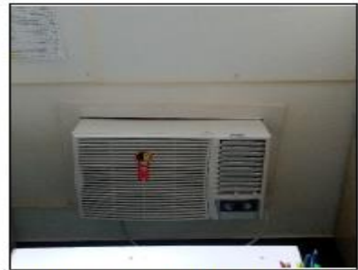
CAM1 - 7 ANDAR - SESPOR AR CONDICIONADO JANELA SPRINGER 18000 121262
