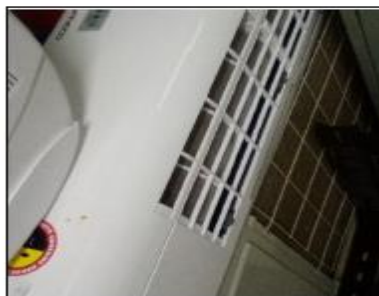
CAM1 - 8 ANDAR - CMDCA AR CONDICIONADO SPLINTER KOMECO 9000 118976
