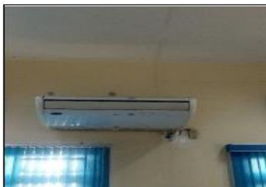
PAÇO - SALA 25 - LICITAÇÕES AR CONDICIONADO CARRIER 43685
