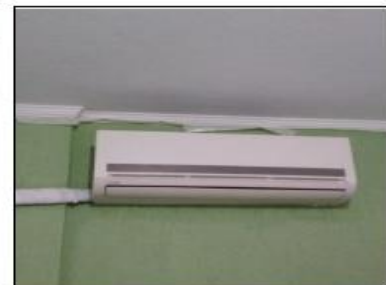
CAM1 - 1 ANDAR - SEAS AR CONDICIONADO SPLINTER 000130
