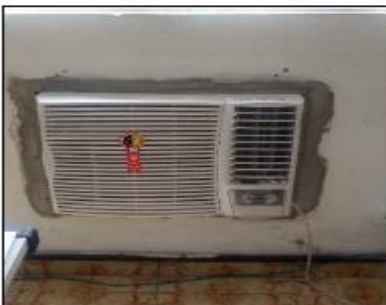
CAM1 - 4 ANDAR - SEMAM AR CONDICIONADO JANELA SPRINGER 125968
