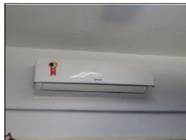
PAÇO - SALA 30 - COGP AR CONDICIONADO SPLINTER CONSUL 128739
