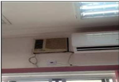
PAÇO - SALA 25 - LICITAÇÕES AR CONDICIONADO JANELA CONSUL 029636
