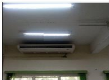
PAÇO - SALA 4 - ATENDIMENTO TRIBUTÁRIO AR CONDICIONADO ELGIN 118777
